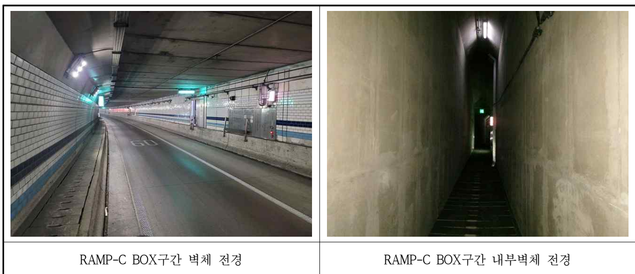
【사진 3.3.22】 BOX구간 벽체 손상현황
