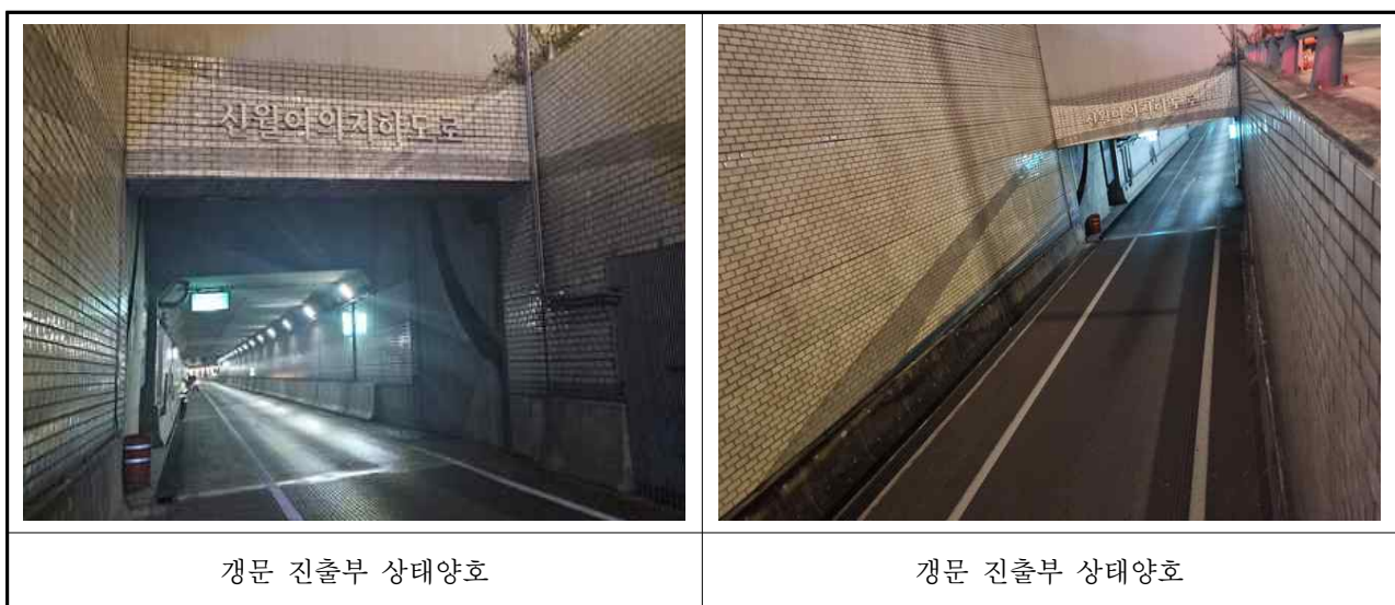
【사진 3.3.36】갯문 손상현황
